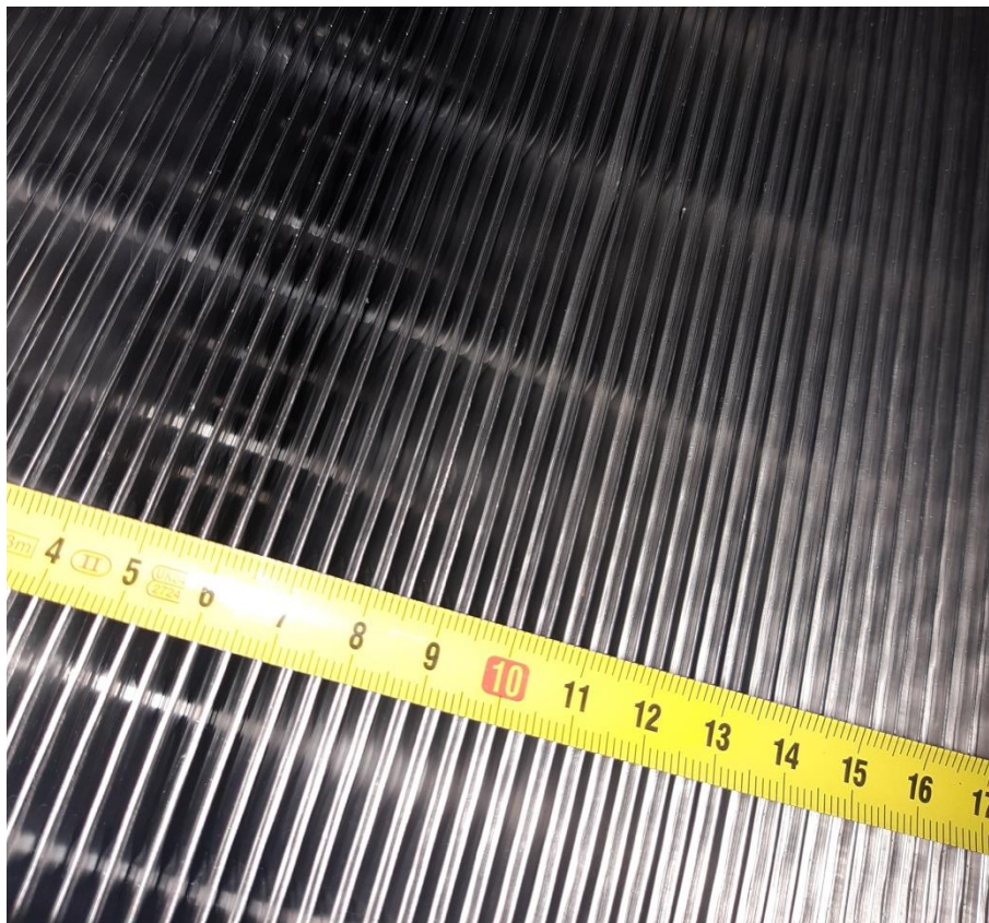
Zoom sur les ailettes de l'échangeur (vue côté air soufflé)
