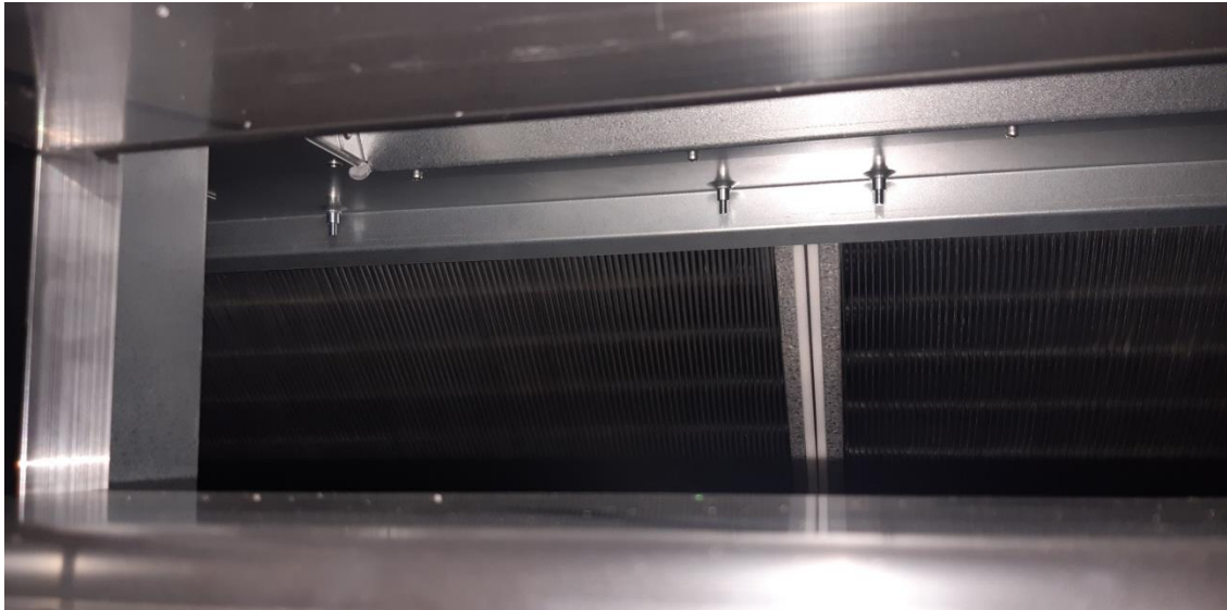
Echangeur vu depuis l'air neuf
