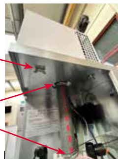
Vue de l'intérieur de l'unité Vapac montrant le RDU in situ
