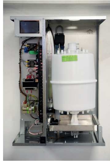
Fig 2g - Unit gemonteerd op muur, geen voorpaneel
