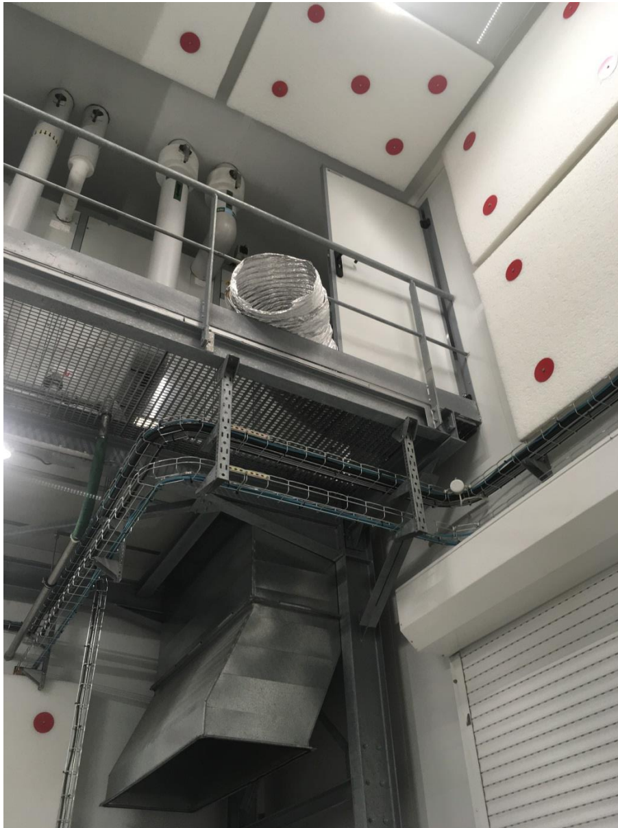
Figure 9 : Côté extérieur (entrée d'air neuf frais)
