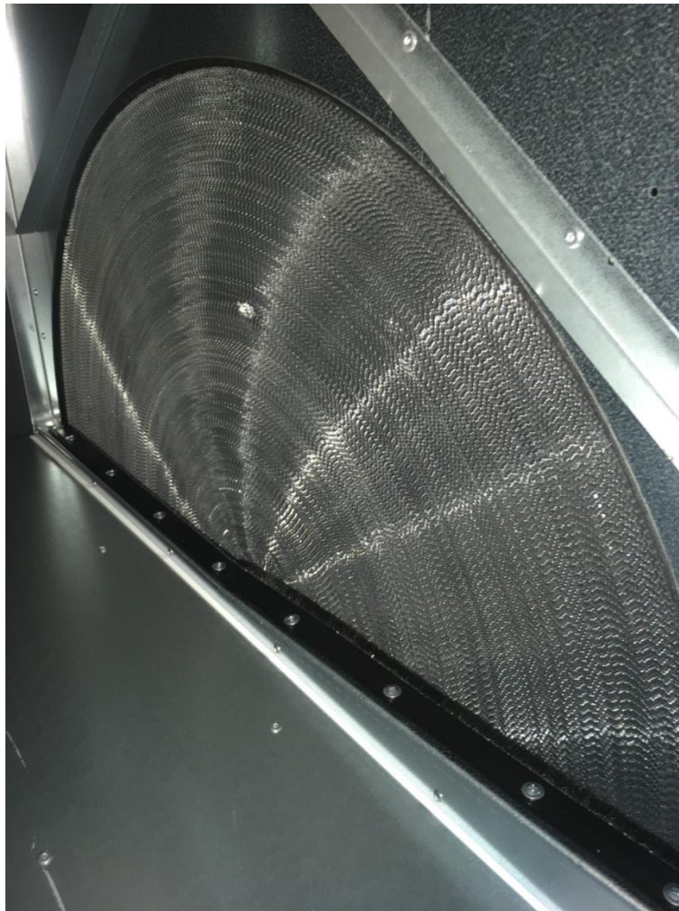
Figure 6 : Vue de l'échangeur thermique du système
